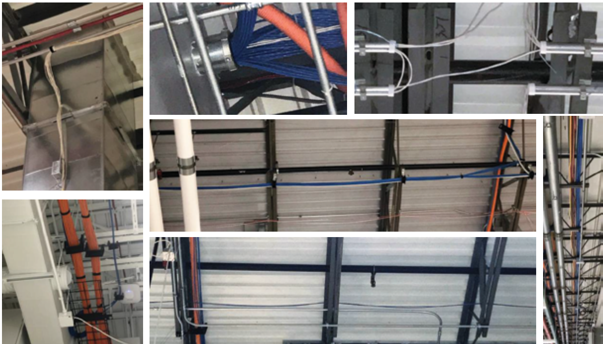
図 3. インピーダンスの不連続が発生しやすい金属表面の例
