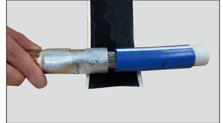
直線接続（アルミ側）からマスキングテープで絶縁、防水加工を実施。巻きの回数は1回でOK。
