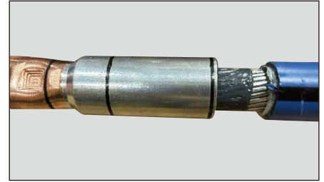
次に、直線接続（アルミ側）にアルミ電線を挿入。 コンパウンドが導体全体に塗布されている事を確認。
