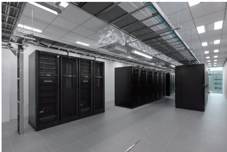
新オフィスのネットワークルーム
