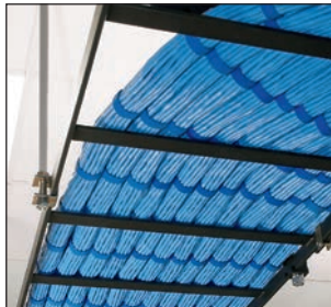
架上におけるロールタイプの使用 HLS-15R6
